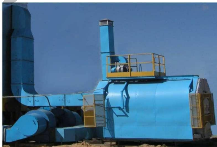
Рис. 3.91. Общий вид теплогенератора АТ-0,8
