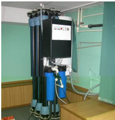
Рисунок – Станция водоподготовки «ГИДРООЗОН»
