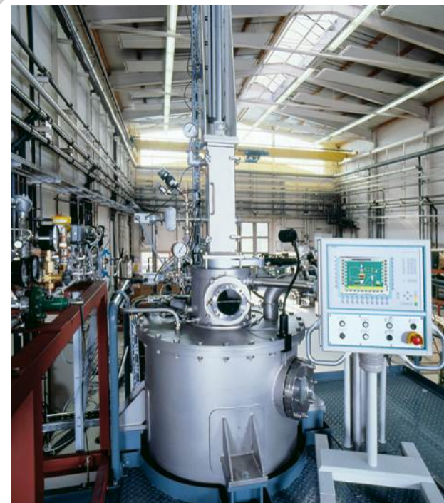
Рисунок 4.15. – Общий вид установки для индукционной плавки электрода с распылением газом
