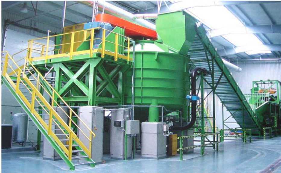
Рис. 51. Линия гидромеханической переработки отходов
