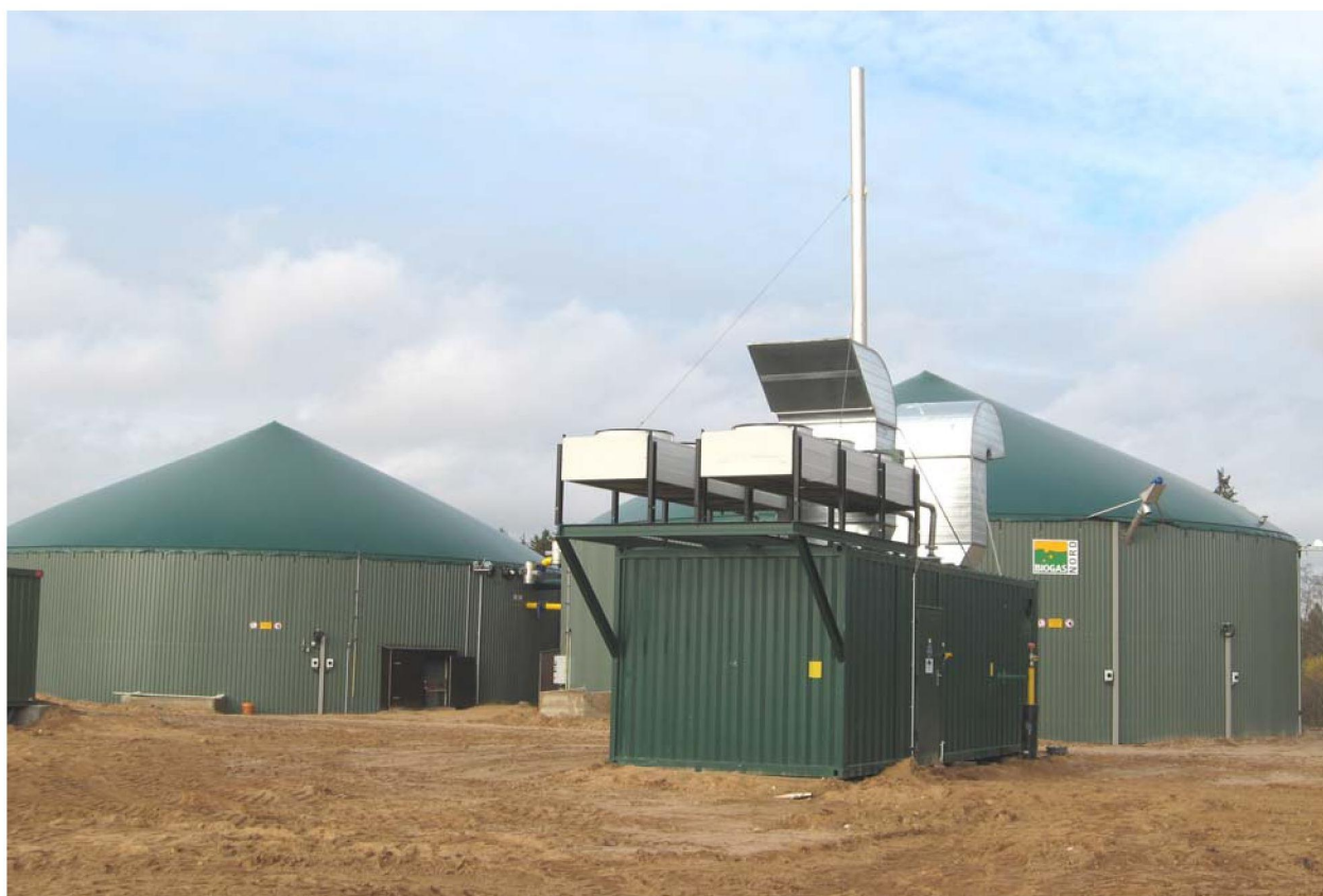
Рис. 39. Биогазовый комплекс племптицевода «Белорусский»
