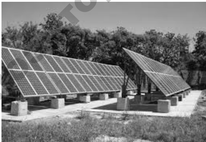
Рис. 5.36. Солнечная электростанция в Испании
