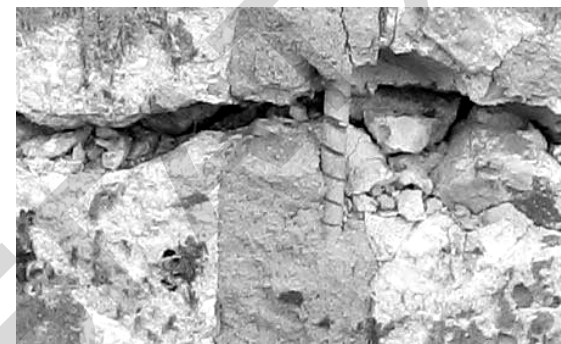
Рис. 5.5. Разделение витков спирали в области трещины
