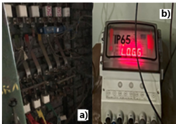
Рисунок 1 – Измерение параметров в исследуемой электрической сети: а) шины 0,4 кВ силового трансформатора 10/0,4 кВ; б) прибор PQ-701
