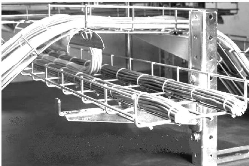
Рис. 4.10. Электропроводка на лотках
