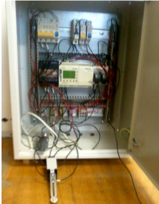
Рисунок 1 Щит управления с монтажной платой и электрооборудованием
