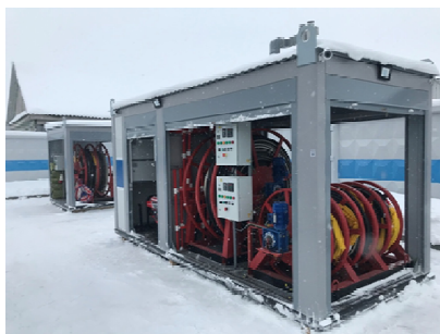
Рисунок 1 – Вспомогательное (слева) и основное (справа) модульные здания системы «Байпас»
