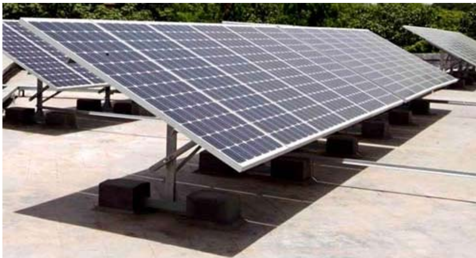
Рисунок 7 – Общий вид солнечных фотоэлектрических панелей
