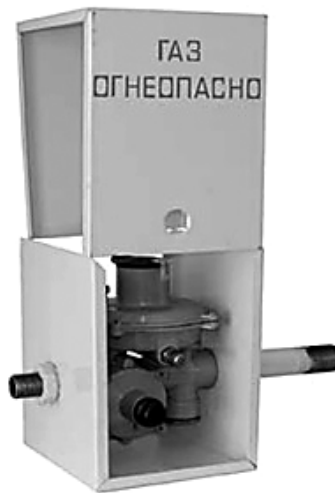
Рис. 5. Узел редуцирования газа домовой УРГД
