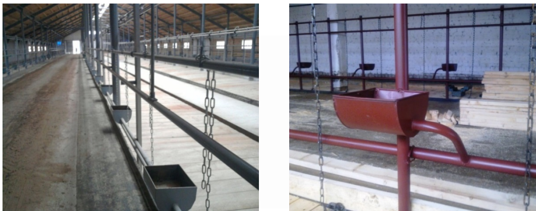
Рис. 2. Системы водопоения ферм КРС
