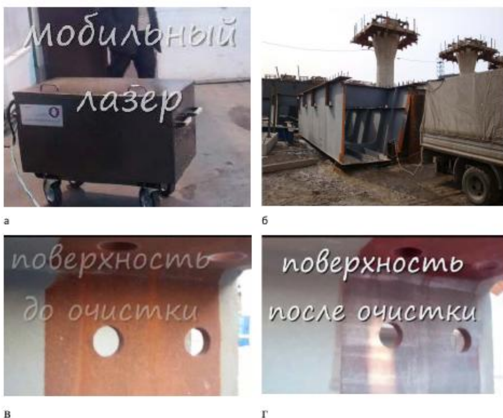
Рис. 3.7. Лазерная очистка стыков от ржавчины ферм моста а – мобильный лазер, б – ферма моста, в – поверхность до очистки, г – поверхность после очистки
