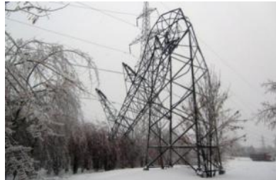
Рис. 2. Разрушенная опора ВЛ под воздействием гололёда.
