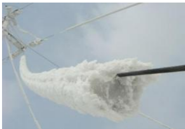
Рис. 1. Образовавшийся гололёд на проводах ВЛ
