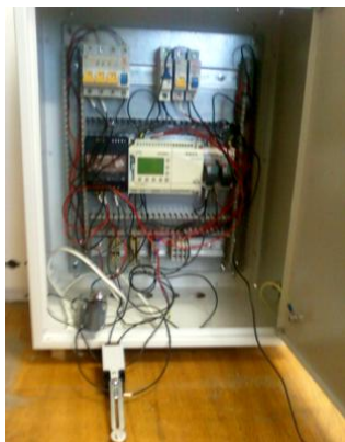
Рисунок 1 Щит управления с монтажной платой и электрооборудованием
