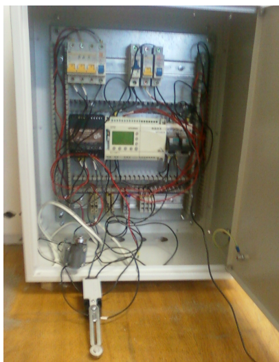
Рисунок 2 – Щит управления с монтажной платой и электрооборудованием
