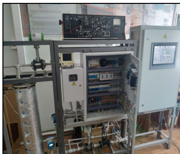
Рисунок 3 – Учебный комплекс по автоматизации нагревательной установки (датчики температуры дТС035, ТП2488, давления ПД100, расхода Эмис Мета-215, Эмис Вихрь-200, уровня АИР-20, регулирующие клапаны 25ч945п, многоканальный регистратор РМТ69L, контроллеры ТРМ151, СПК207, модули ввода/вывода MBA8, MB110, MBY8)
