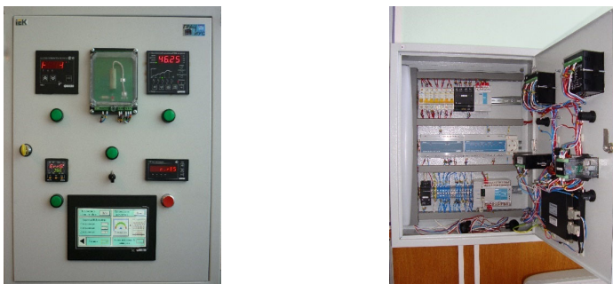
Рисунок 1 – Лицевая и внутренняя панели учебных шкафов в лаборатории систем цифрового регулирования на базе контроллеров ОВЕН (цифровые регуляторы ТРМ1, ТРМ251, ТРМ101, счетчик импульсов СИ8, модули ввода/вывода МВ110, МВА8, МВУ8, программируемый логический контроллер ПЛК110, операторская сенсорная панель СП270, эмулятор печи ЭП10)
